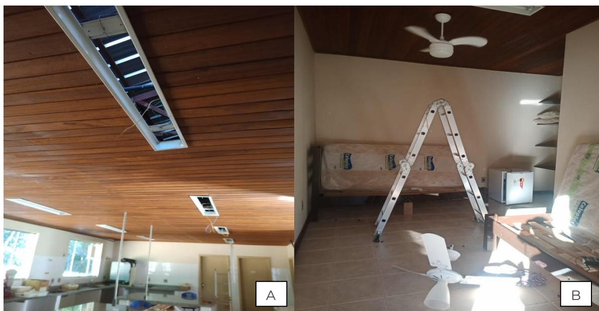
Figura 37. Centro de Pesquisas. A e B) Substituição de todas as lâmpadas fluorescentes por lâmpadas led nos laboratórios, cozinha, banheiros e alojamentos do Centro Pesquisas, incluindo substituições de ventiladores que estavam em curto elétrico. Junho/2023.
