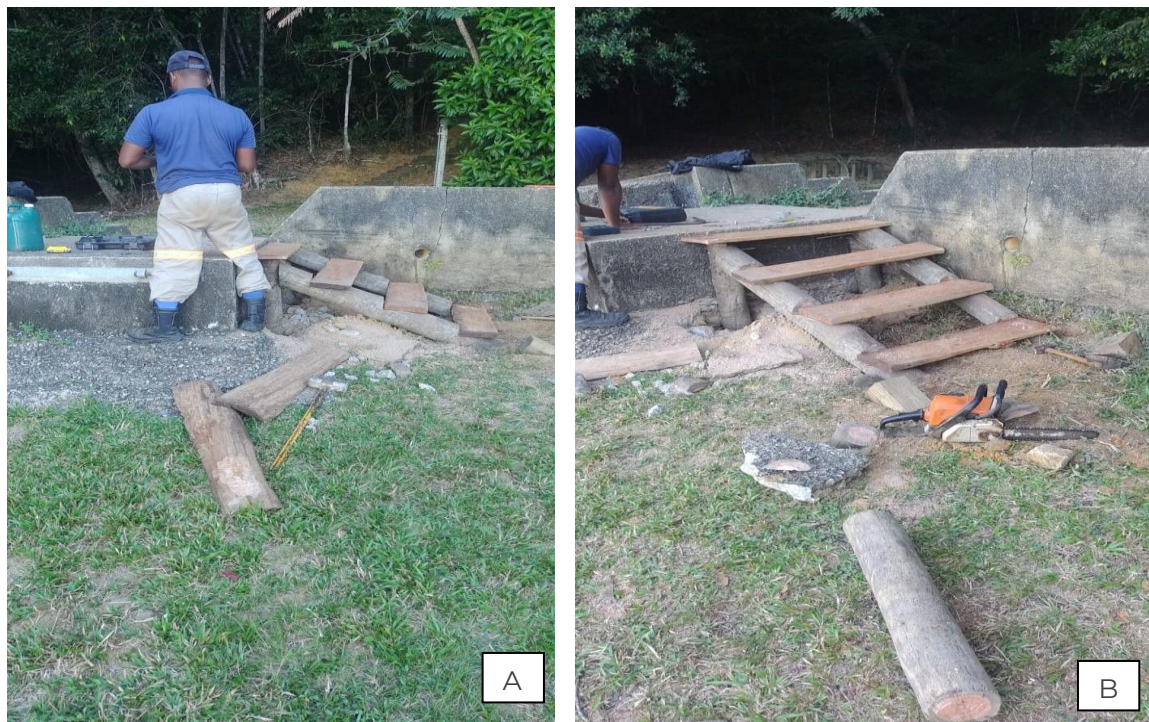
Figura 10. Adequação de acesso. A e B) Construção de escada de acesso para as áreas de contemplação e de embarcação localizadas às margens do Lago Dom Helvécio, próximo à Casa de Tábua. Abril/2023.
