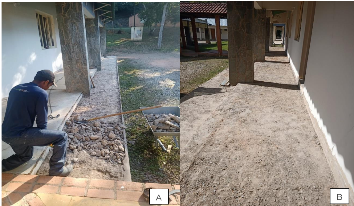
Figura 35. Herbário. A e B) Demolição de calçada danificada e retirada do entulho. Junho/2023.
