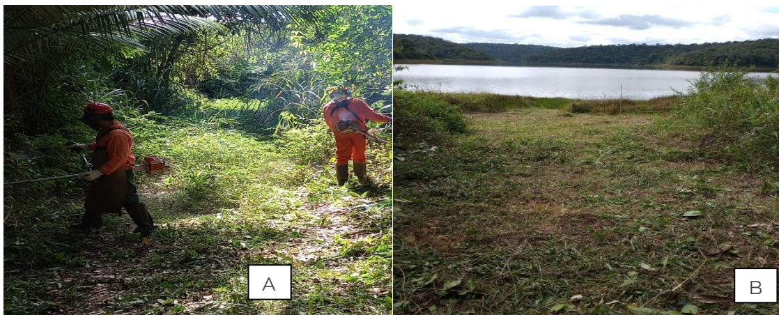
Figura 42. Lagoa Águas Claras e Lagoa dos Patos. A e B) Com o objetivo de viabilizar as atividades de pesquisa e fiscalização, foi realizada a roçada com retirada de vegetação em toda extensão da estrada de acesso às lagoas Águas Claras e do Patos. Junho/2023.
