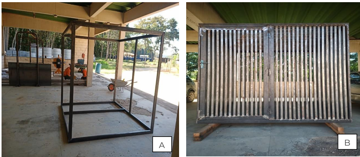
Figura 36. Gaiola de armazenamento. A e B) Construção de gaiola para armazenamento de combustível e resíduos inflamáveis. Junho/2023.
